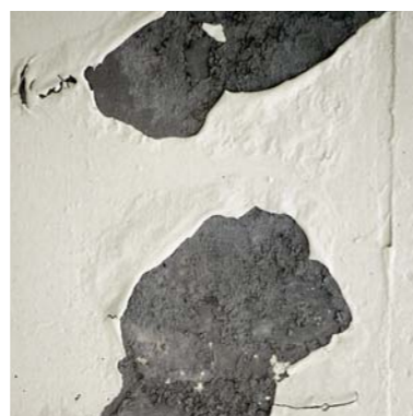
Разрушенная гидроизоляция вследствие осмотического давления
