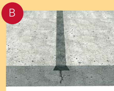
Узел В. Устранение течей сквозь «холодные швы» (швы переменного бетонирования) с помощью шовных составов Emaco и Masterseal.
